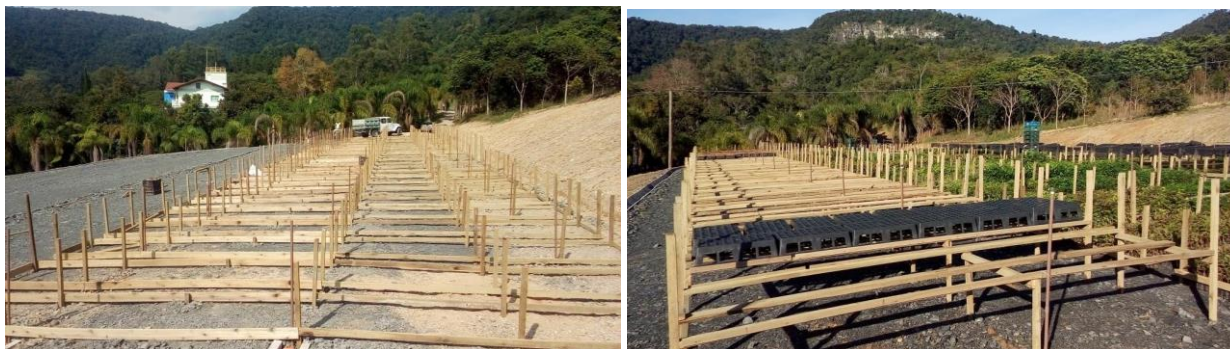
Fotos 08 e 09: Etapa 01 – Construção de canteiros e acondicionamento das mudas que já estavam prontas para plantio.
